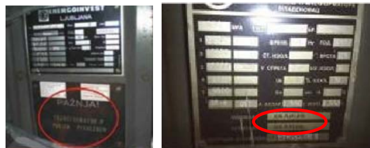
Identifikacione pločice na transformatorima
